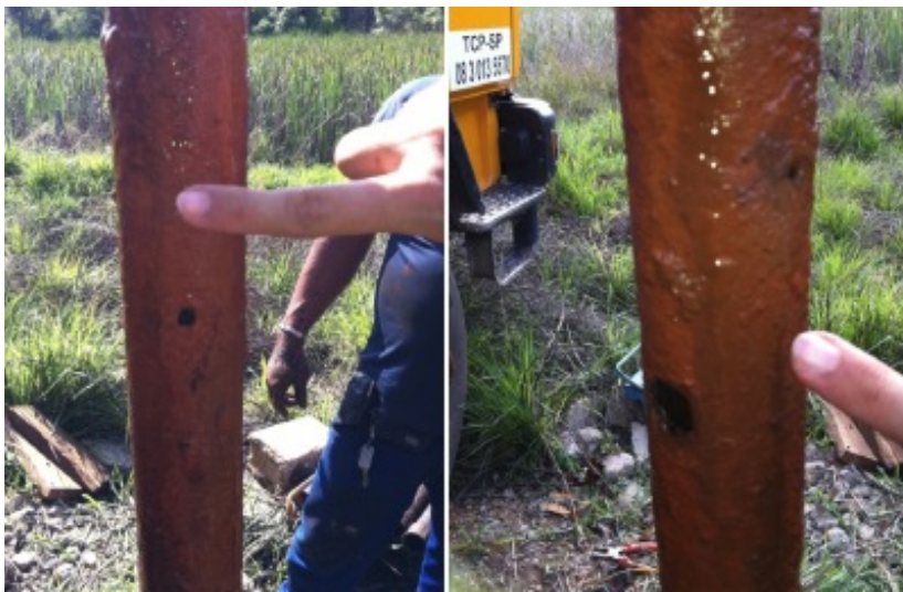
Furos encontrados na tubulação.
