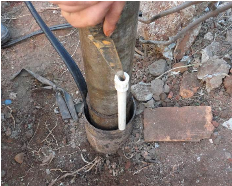
Espaço insuficiente entre tubulação e revestimento do poço.
