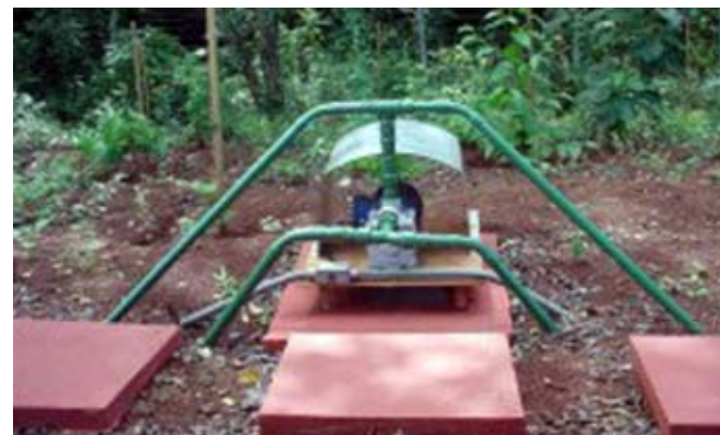
Exemplo de uma única bomba de superfície sendo utilizada para dois poços de recuperação.
