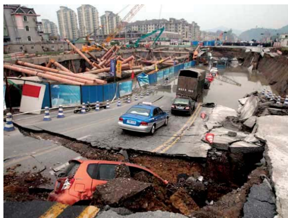
Acidente semelhante ao ocorrido em São Paulo registrou três mortes, além de 11 veículos engolidos, em desabamento do túnel do metrô em Hangzhou, leste da China
