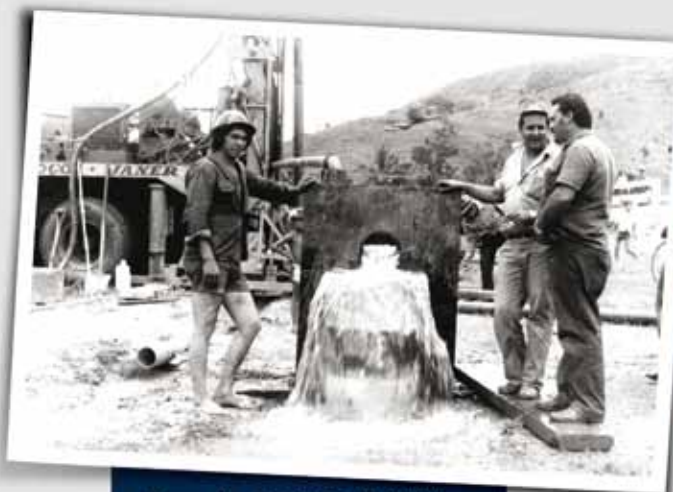
Poço da COPASA. Itabirinha de Mantena (MG), 1976
