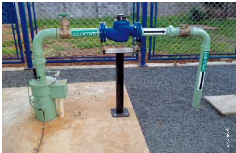
Poços tubulares profundos são usados para captação e uso da água para produção e consumo
