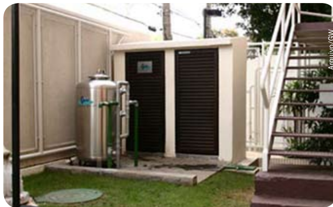
Sistema de tratamento da General Water no Hospital Santa Paula.
