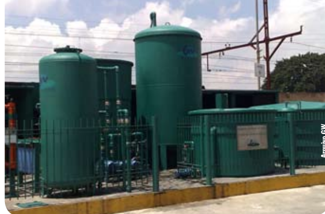
Estação de tratamento de esgotos do ABC Plaza Shopping.
